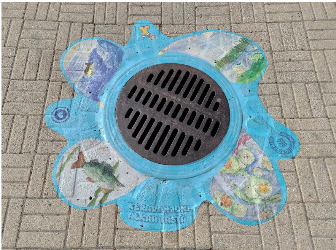
Kuva 18. Hulevesikaivon ritaläkannen ympärille asennettu tarra, joka kertoo ohikulkijoille Keravanjoen alkavan tästä hulevesikaivosta. Tarroja asennettiin Keravan kaduille kesällä 2024.
