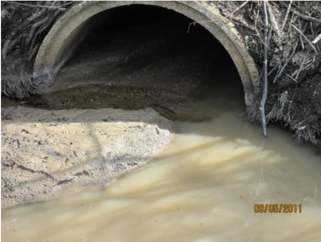
Kuva 10. Itäisen hulevesialtaan rakentamisesta johtuva voimakas kiintoaineen huuhtoutuminen tukki lähes umpeen Kulomäentien alittavan rumpuputken (kuva: Pasi Valkama 2011).
