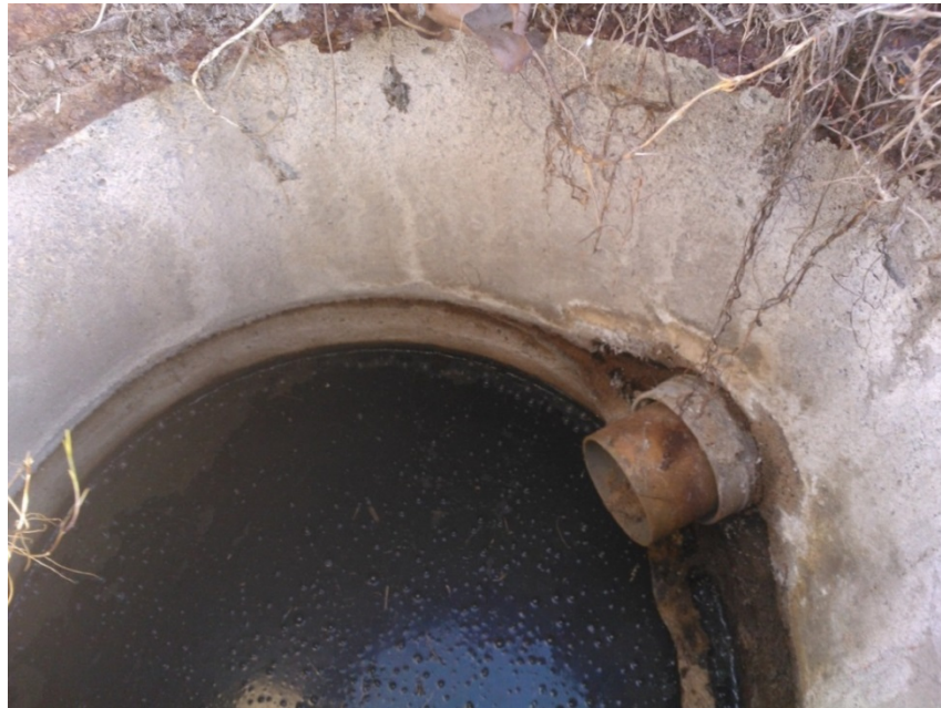
Kuva 1. Kaikille jätevesille tarkoitettu vanha rapautunut betoninen saostussäiliö.
