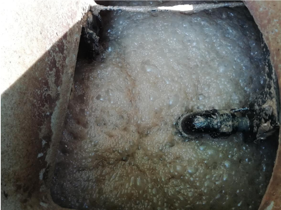
Kuva 4. Pienpuhdistamot vaativat huolellista hoitoa ja tarkkailua. Tämän pienpuhdistamon ongelmana oli voimakas vaahtoaminen, joka heikentää puhdistustulosta.
