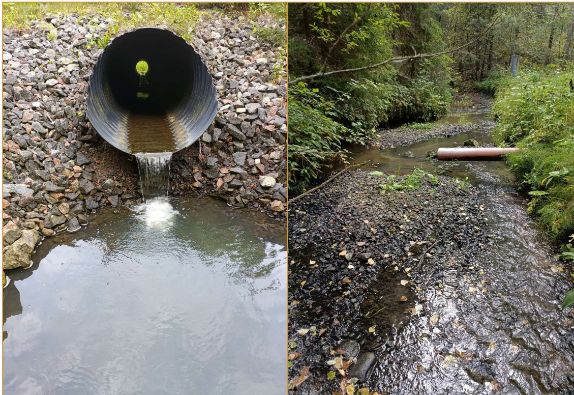
Kuva 10. Vasen: Vanhan valtatie tierumpu oli kalojen nousueste. Tierumpu oli korkealla, mutta voimakkaalla virtaamalla suurikokoinen kala voi päästä hyppäämään rumpuun. Oikea: Jusliininojan alaosalla oli runsaasti lohikalojen kutemiseen soveltuvaa soraa, joka oli vähävetiseen aikaan osittain kuivillaan.
