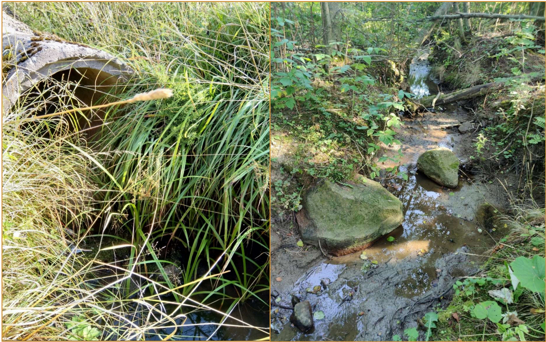
Kuva 3. Vasen: Yläosa oli hyvin umpeenkasvanutta ja peltoalueella sijaitseva rikkinäinen tierumpu, joka toimii todennäköisenä vaellusesteenä alivirtaama-aikaan. Oikea: Kylmänojan yläosa oli varsin vähävetinen
