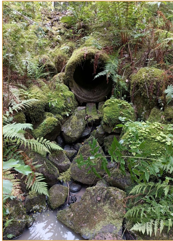
Kuva 25. Ojamäenpuron alaosan huonokuntoinen tierumpu. Kohta toimii nykyisellään täydellisenä vaellusesteenä.
