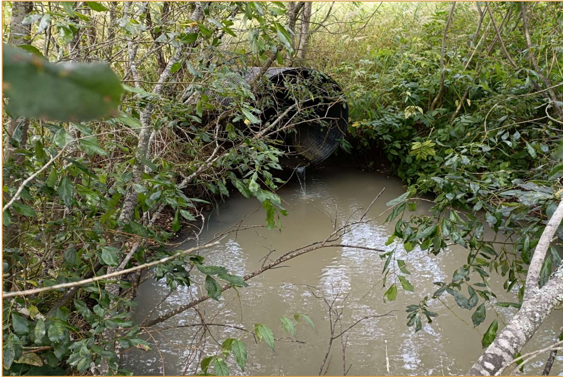
Kuva 13. Kellokoskentien tierumpu on korkealla, noin 10–15 cm alapuolisen altaan vedenpinnan yläpuolella. Inven- toinnin aikana vallinneena virtaamassa rumpu on kaloille nousueste.
