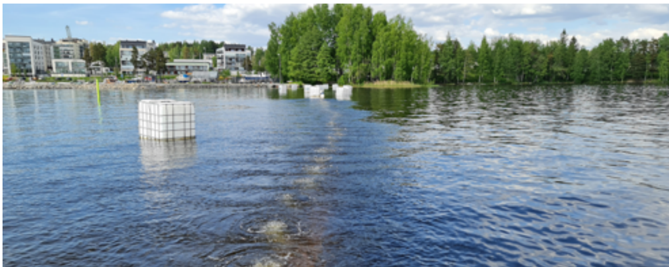
Kuplaverhossa rei'itetystä putkesta vapautuu ilmakuplia, jotka pitävät kiintoainepitoisen veden kuplaverholla ympäröidyn alueen sisäpuolella. Kuva: Antti Ukonjärvi, Pimara Oy.
