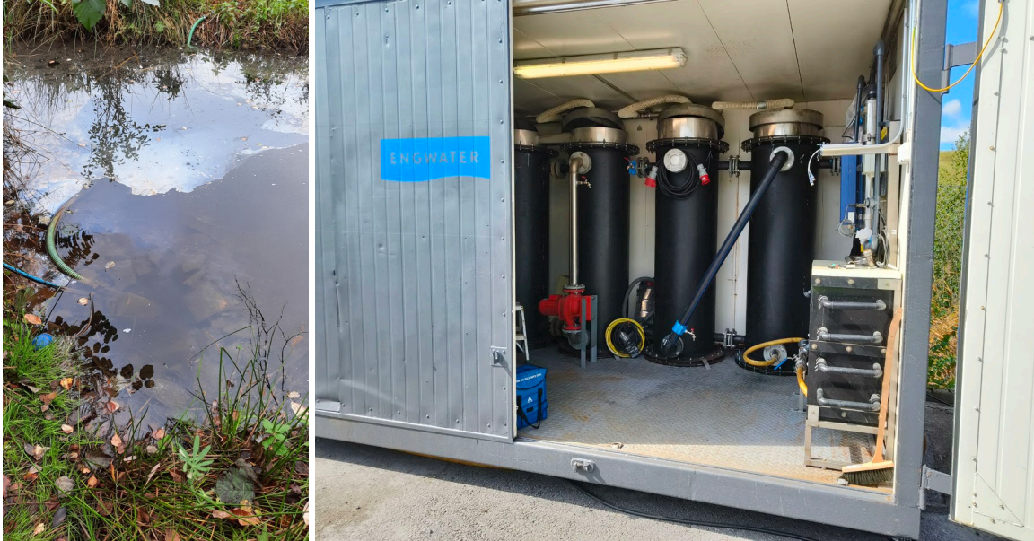
Kuva 5. Vasemmalla kuva pumppauspoterosta, johon uppopumppu oli asennettuna ja oikealla kuva veden suodatuslaitteistosta.
