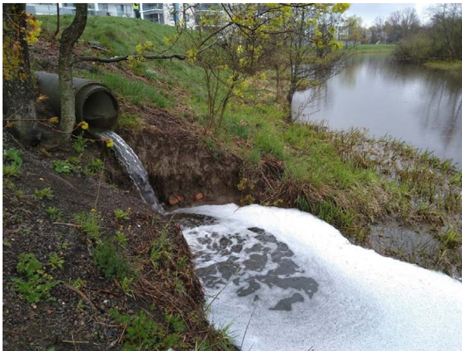
Kuva 9.1. Jokipenkkaa sortanut hulevesirumpu tuo vesiä pientalovaltaiselta asuntoalueelta Keravanjokeen (kuva VHVSY). Vedessä olevat pinta-aktiiviset aineet, mm. humus, aiheuttavat usein vaahtoamista vesien ollessa kylmiä.
